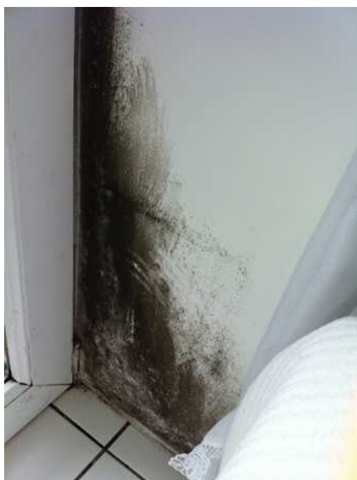
Neu- oder Altbau: Schimmelbefall tritt häufig in Fensterleibungen (Wärmebrücken) auf.
