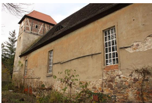
Bild 5: Ev. Kirche Biederitz vor der Sanierung
