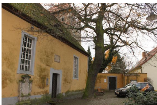
Bild 7: Die Fassade mit Feuchteschäden
